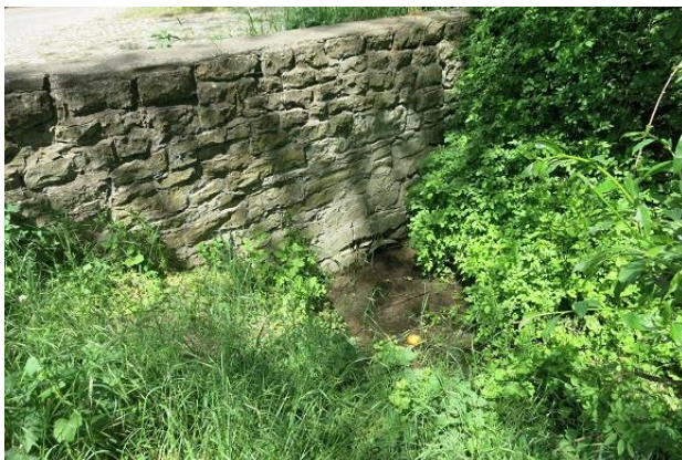
Abbildung 28: Verlandeter Durchlass in Abschnitt 3 (Blick gegen Fließrichtung)
