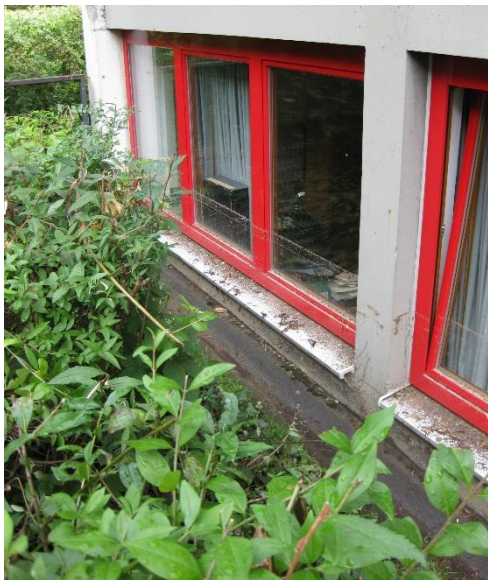
Abbildung 4: Spuren der Überflutungen des Kellergeschosses der Eugen-Bolz-Schule
