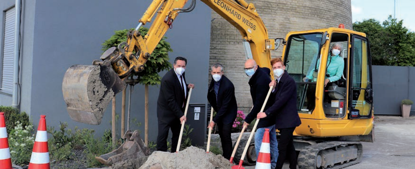
v.l.n.r. Christian Schneider, Vorsitzender der Geschäftsführung der SWLB, Johannes Rager, Geschäftsführer der SWLB, Jörg Schuttenberg, Abteilungsleiter Bau und Betrieb Telekommunikation SWLB, Benjamin Voß von der ATENE KOM GmbH und Ursula Keck, Oberbürgermeisterin der Stadt Kornwestheim
